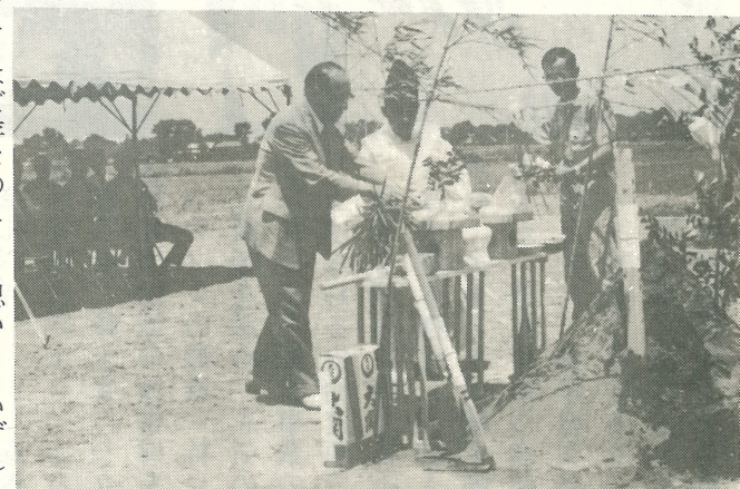
▲稲敷地方広域市町村消防事務組合竜ヶ崎消防署利根出張所の庁舎の起工式が、7月22日中田切地先で行なわれました。完成は本年12月25日の予定。
