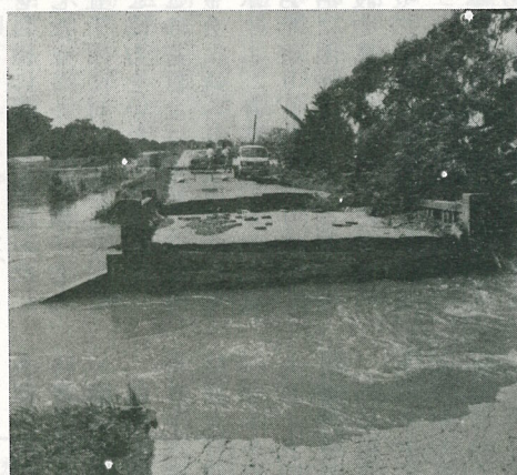
▲論所排水の増水により決壊した大房橋付近
