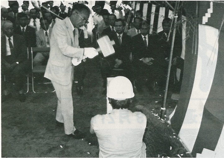
▲去る 8月2日、(仮称)新立中学校の校舎及び屋内運動場の起工式が行われました。
