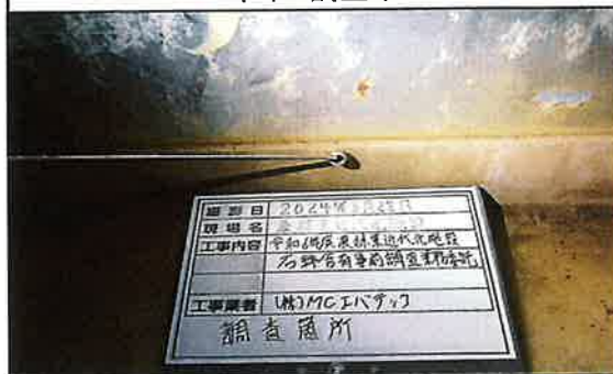
18 栽培棟 栽培室 巾木 調査中
