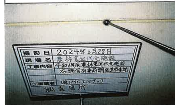
38 栽培棟 予冷库 シーリング 調査中
