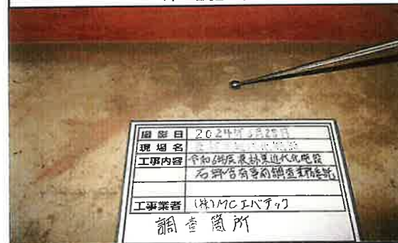
22 栽培棟 通路 床 調査中
